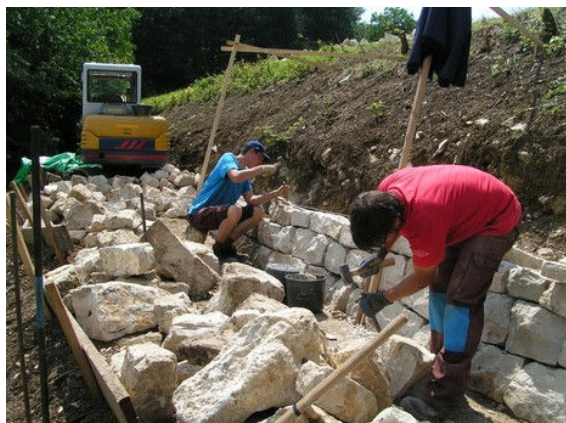
Kalkstein um Kalkstein wird die Trockenmauer bis auf 1,6 m Höhe aufgebaut. NN
